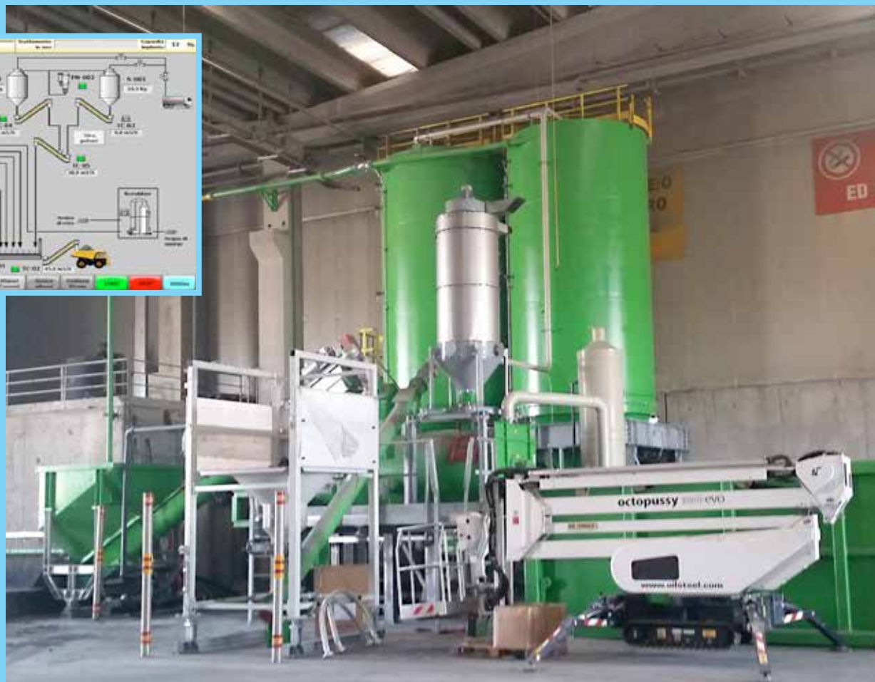
Impianto di inertizzazione polveri
