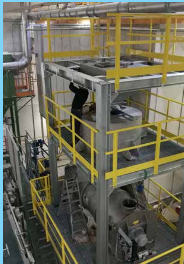
Impianto movimentazione e stoccaggio zucchero in area atex
